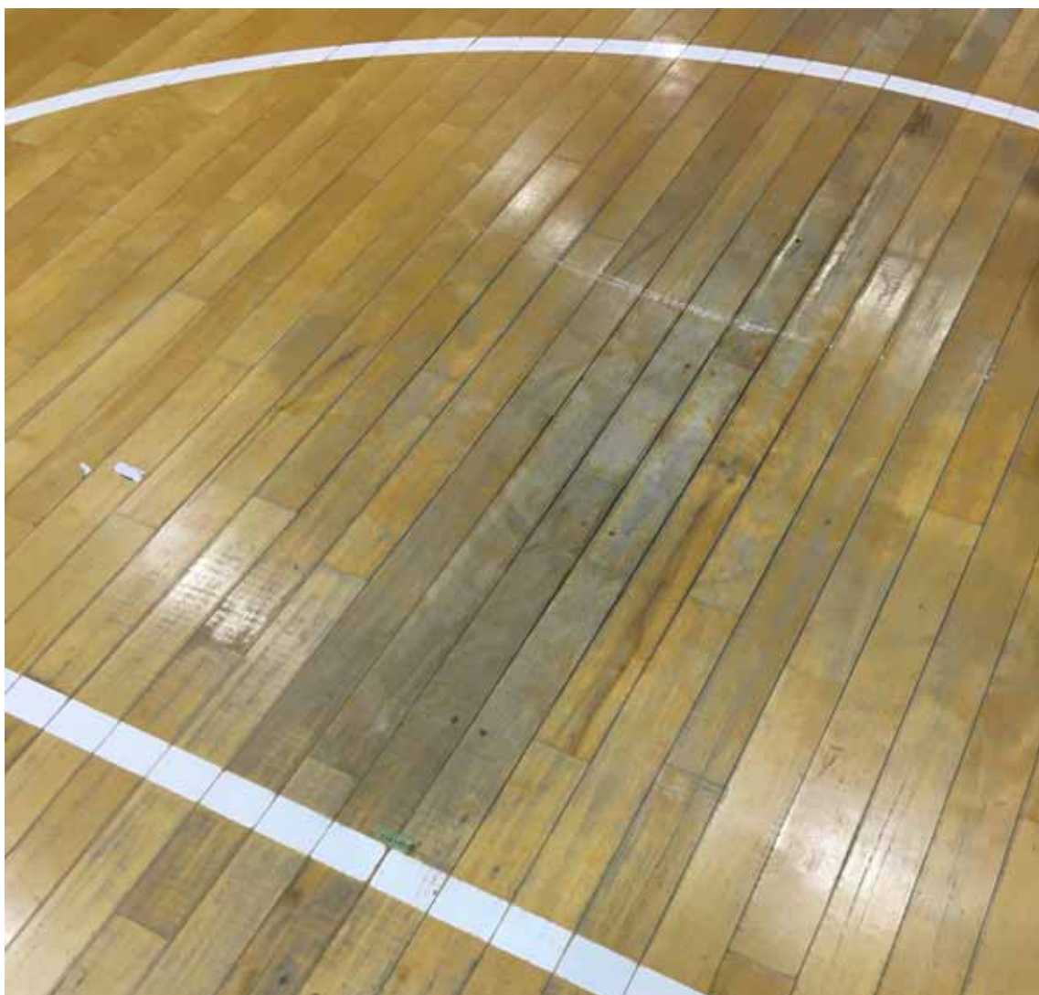
長堂小学校 雨漏り跡の床が変色
