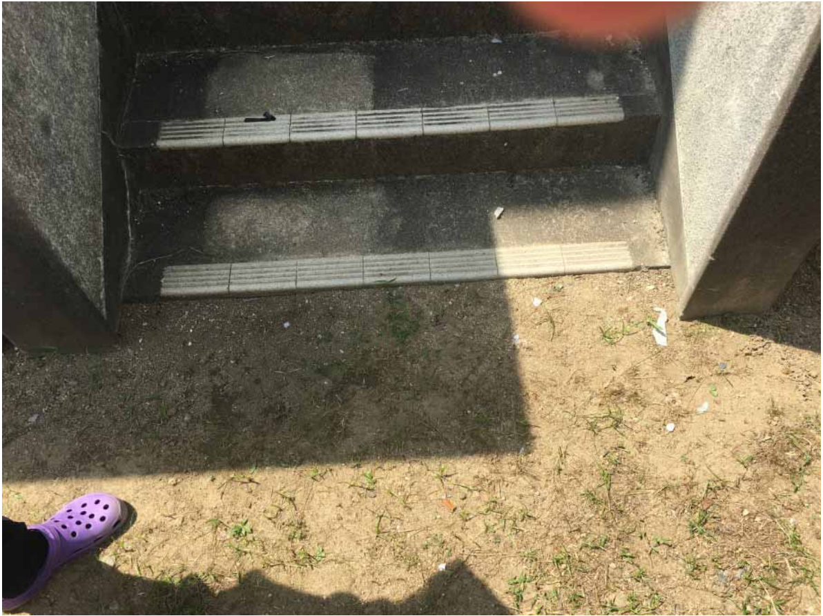
階段の1段目が埋まっている
