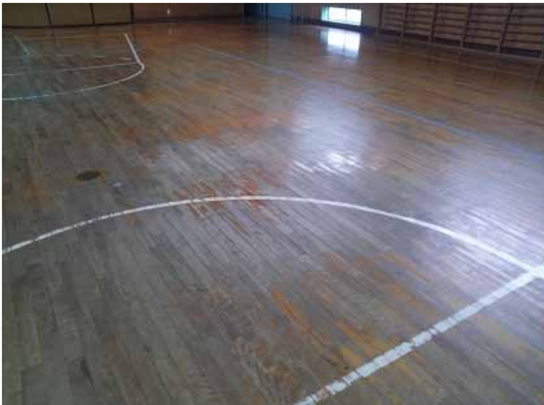
北宮小学校 中央部が剥げてきている
